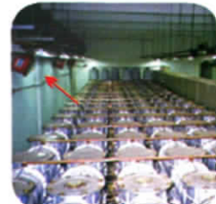
33KV Trạm tiếp điện
